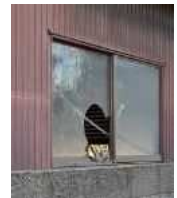
窓が割れた管理不全空家
