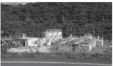
上宮津浄水場
