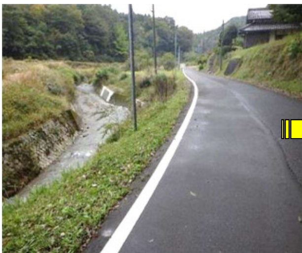
車両などが川に転落しそうで危険
