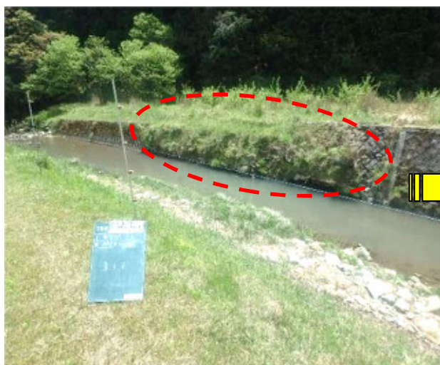
河川護岸が崩れかけており危険
