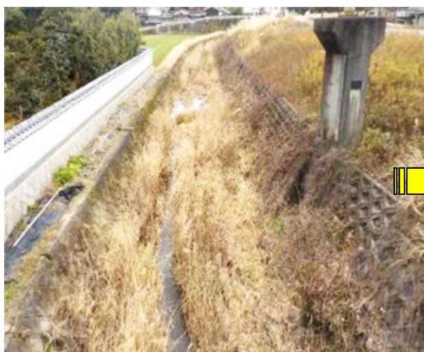
土砂が河川を阻害しており危険
