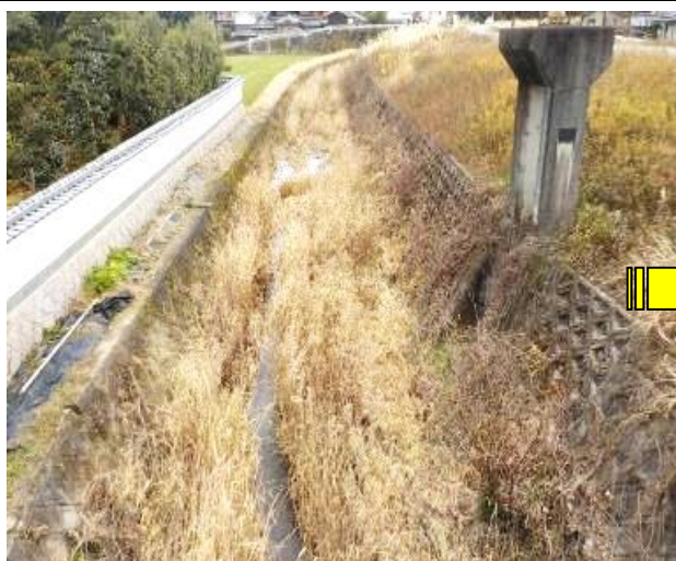
土砂が河川を阻害しており危険
