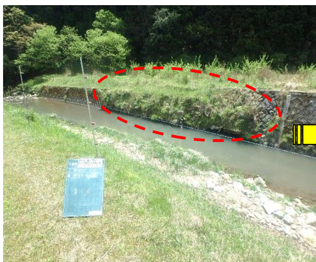
河川護岸が崩れかけており危険
