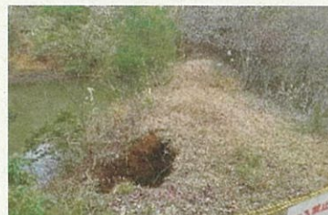
陥没した堤体
