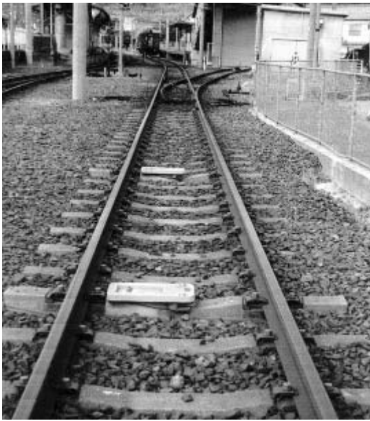
KTR宮津駅付近のATS - SW (自動列車停止装置)
