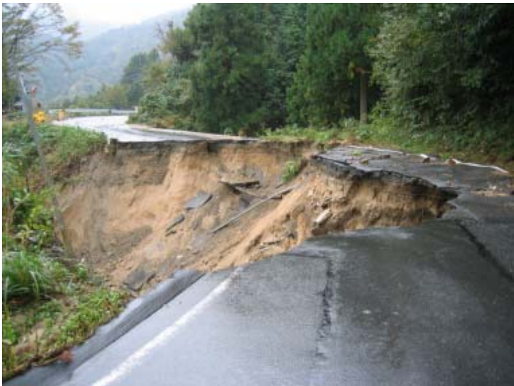
府道綾部大江宮津線の道路崩壊
